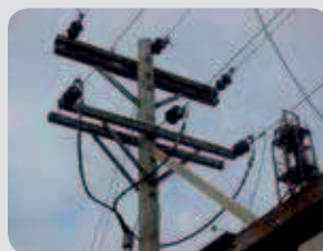
Chyba rozvodného vedení
